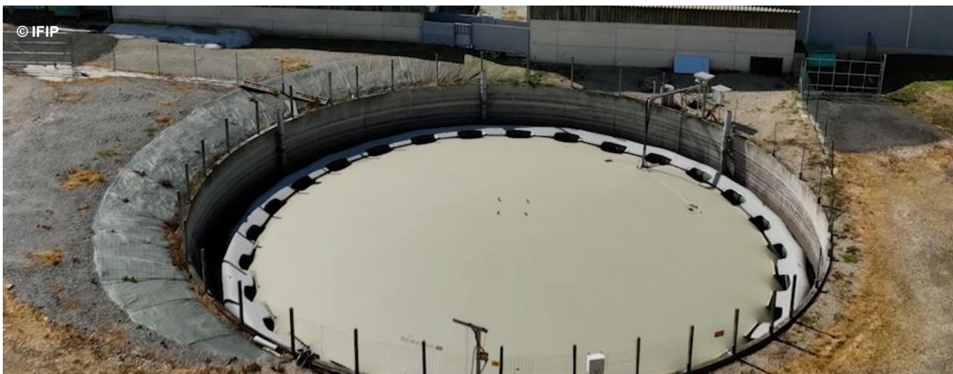
Couverture flottante de collecte du biogaz sur une fosse de 1200 m 3 de 24 m de diamètre
