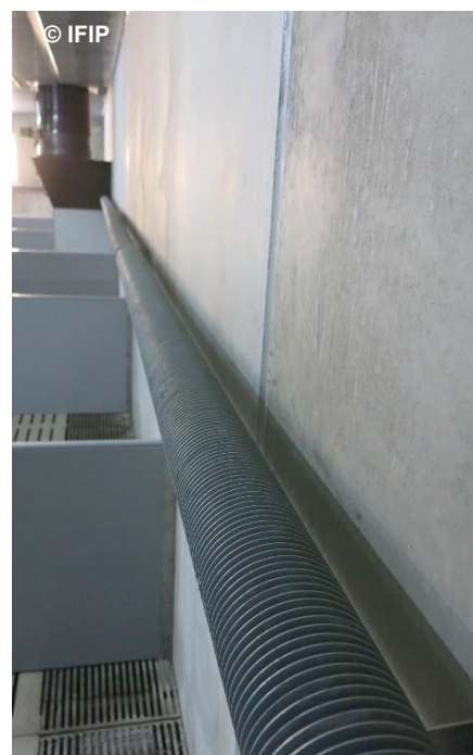
Aérotherme ou tube à ailette pour dissiper la chaleur dans les salles d'élevage
